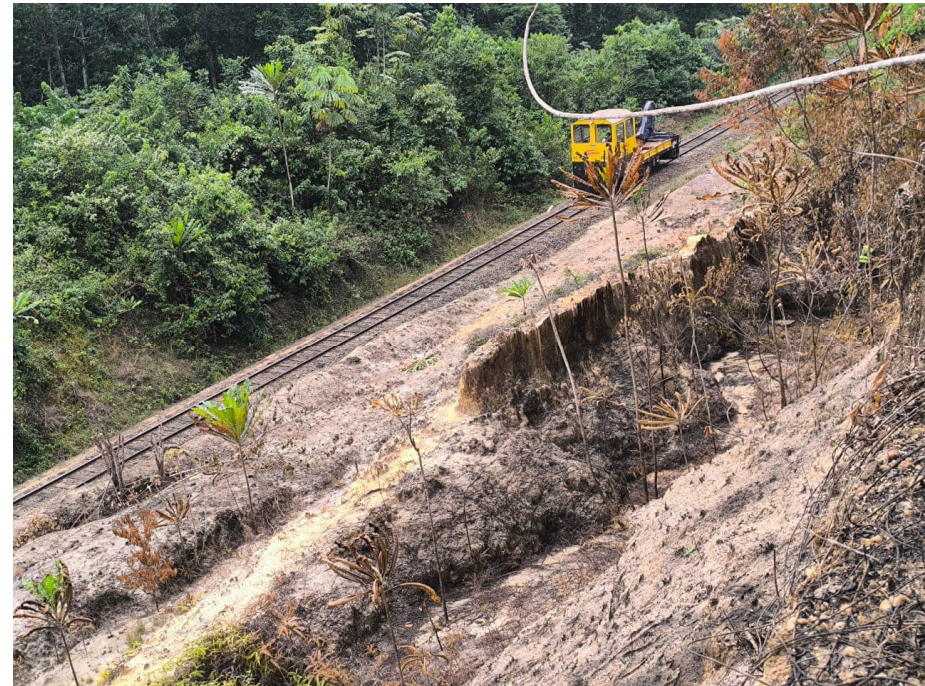
Zone d'éboulement du PK 36
